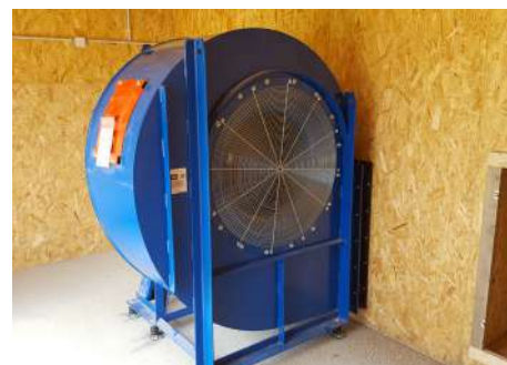
Ventilateur Insuffle l'air sous les caillebotis
